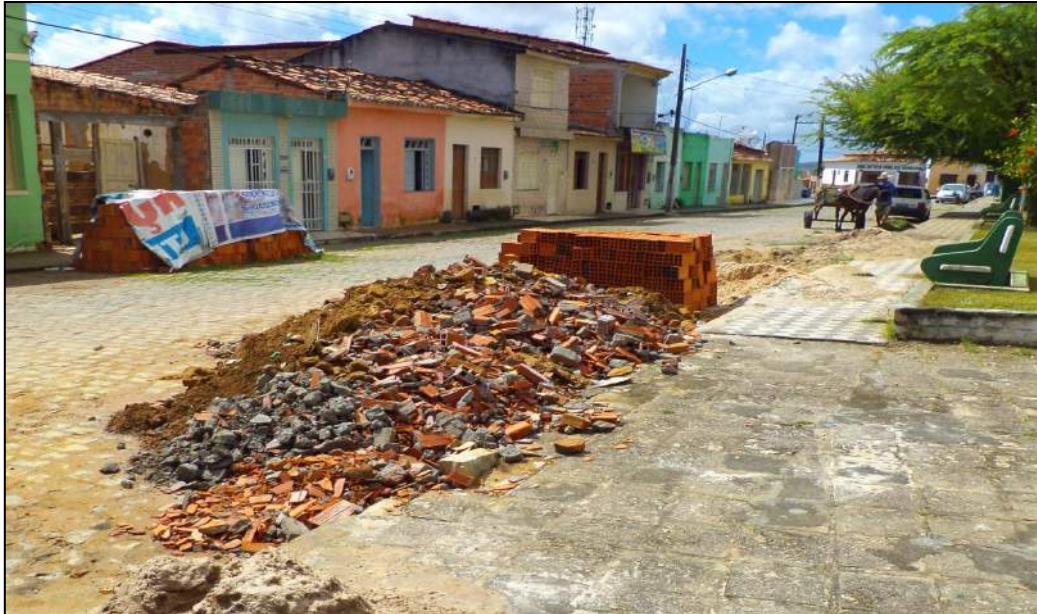
Figura 25: RCC acumulados em via pública – Siriri/SE.
