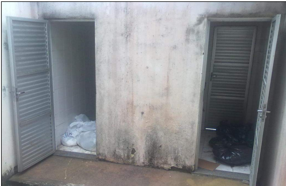
Figura 23: Abrigo de RSS perigosos e comuns– Malhador/SE.
