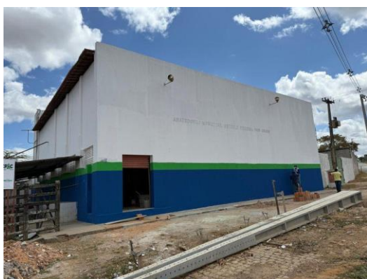
Obra em andamento – reforma e adequação do Abatedouro Municipal para Galpão de Reciclagem (Frei Paulo/SE)
